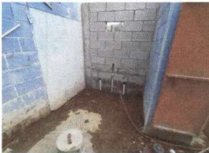
Foto 9: Sustrucción de mingitorio
