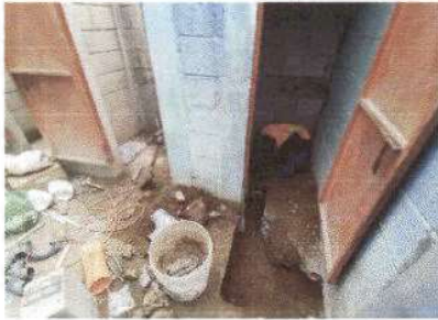
Foto 7: Sustrucción de inodoro
